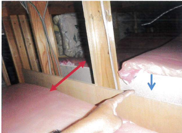
292-1 洗面室→台所 *断熱欠損
