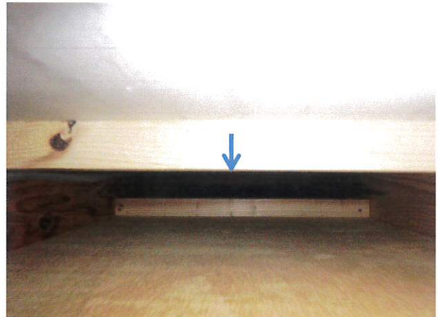
292-2 *間仕切り壁内への外気(湿気)の侵入
