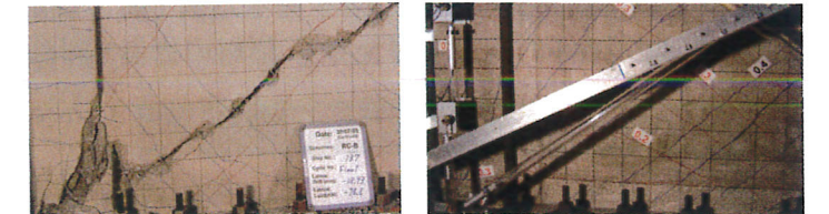
鉄筋で補強した壁は、ひび割れ間隔が不均一になり、左右に繰り返し変形すると一箇所のひびが大きく開いてずれ壊れます。SRFを裏側に貼ると、ひび割れの間隔が均等になり、一箇所当たりのひび割れ幅が小さくなるので、左右に繰り返し変形しても元にもどるのでずれません。
