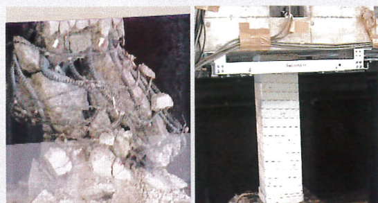
4波目の時点で柱が大破し、壁も崩れてしまいました。7波目の地震にも柱は耐え抜き、壁も目立った損傷はありません。
