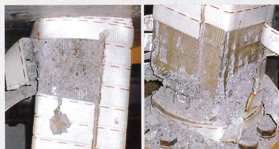
7波目加震後のSRF工法による補強柱内部の状況。柱頭と柱脚のごく一部が粉砕されていますが、他はほぼ健全です。
